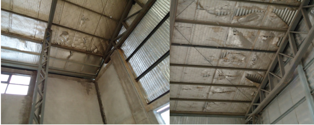
Vistas Interiores – Indicativo de Membranas deterioradas-
